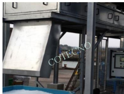
PESAJE Y DOSIFICACIÓN ESCAMAS DE HIELO
