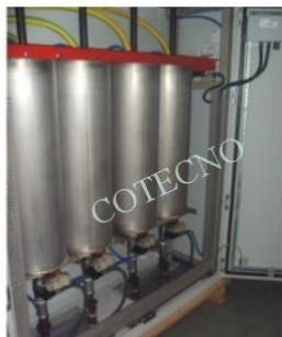
DOSIFICACIÓN DE ADITIVOS LÍQUIDOS
