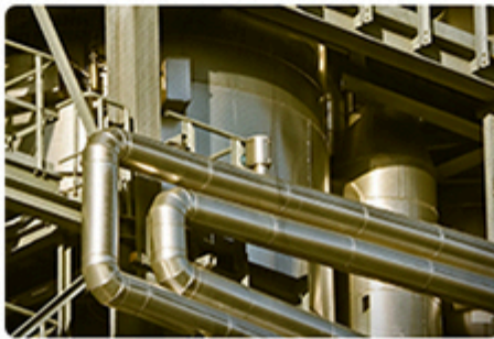
Tanque de agua industrial
