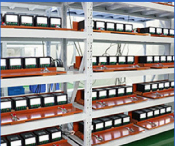
prueba de encendido de 48 horas
